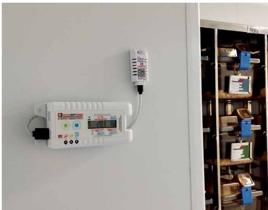
Рис. 2. Система «СканЭйр Темп 101», установленная на объекте
